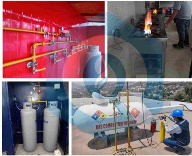
Figura 14: Sistema industrial de Gas Centralizado de GLP.
