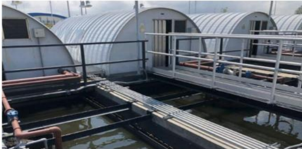
Figura 1. Planta de tratamiento de aguas residuales de Quipor
